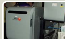
Saint Hilaire du Maine Chaufferie dédiée
